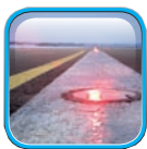
Oświetlenie lotnisk w technologii LED
